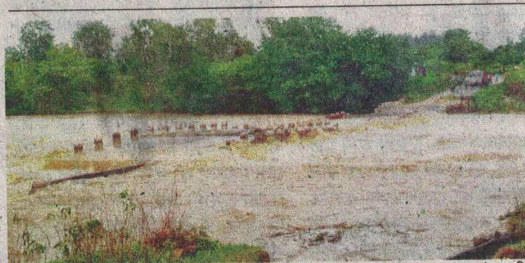
अनूपपुर। जिला मुख्यालय से हरी गांव जाने वाले मार्ग पर तिपान नदी का पुल बाढ़ के पानी से क्षतिग्रस्त हो गया।
