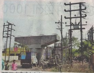
सुभाष नगर ओवरब्रिज निर्माण में हाईटेशन लाइन के कारण काम ठका है। ● नईदुनिया
