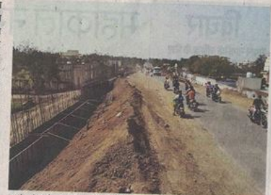
सागाद रोड पुलिया चौड़ीकरण में रिटैनिंग वाल का निर्माण किया जा रहा है। ● नईदुनिया
