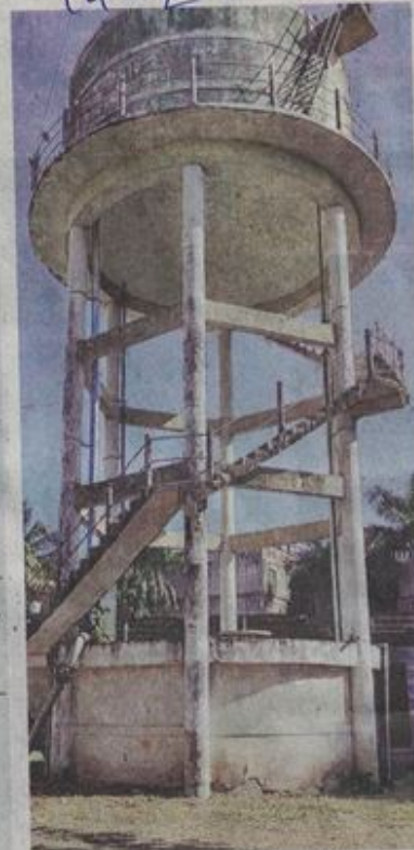
ग्राम धौसवास में निर्मित पेयजल टंकी। ● नईदुनिया
